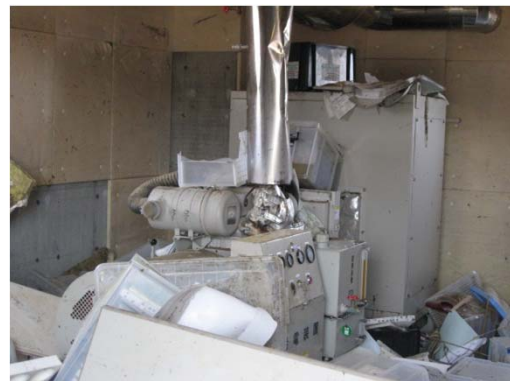
【気仙沼国道(出) 無線局舎(1F)】 地震動の影響はないと思われるが、津波で水没し、 資料などが散乱している。
