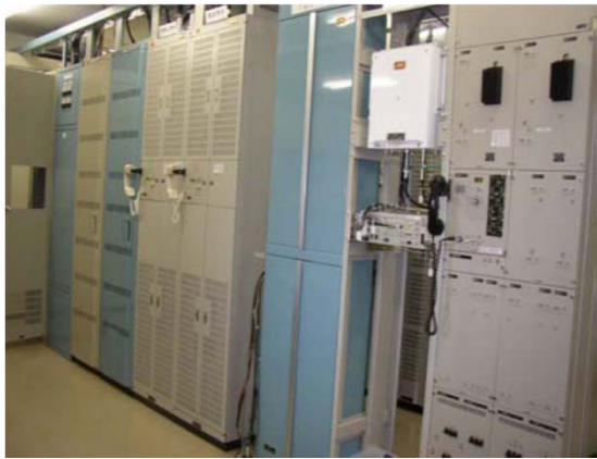
【北上川下流局】 装置架列の状況に異常なし
