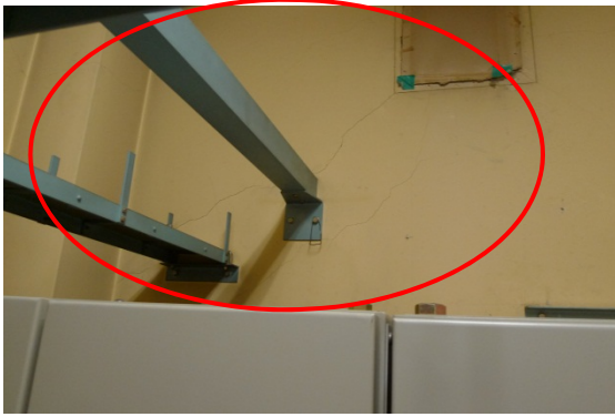
無線室内の壁面に亀裂あり
