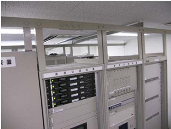
【古川国道局】 画像切換装置等：上下固定により異常なし
