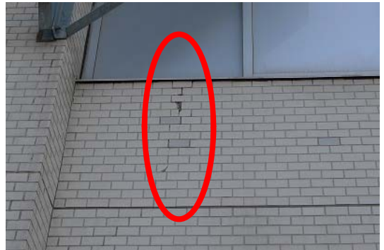
庁舎外壁面 亀裂
