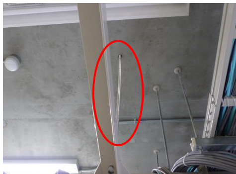
ストラクチャー吊りボルト曲がり有り
