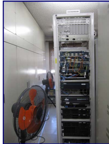
【東北地整 本局（仙台局）】 災害対策室機器室：映像設備が傾斜している。
