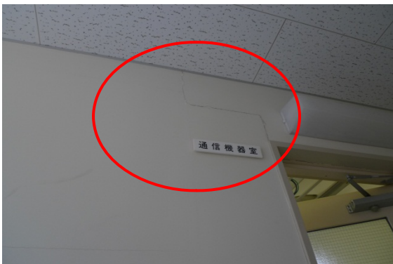
無線室入口の壁面に亀裂あり
