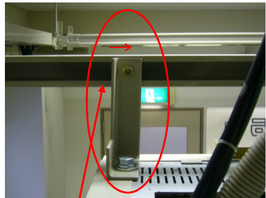
上部固定金具曲がりあり
