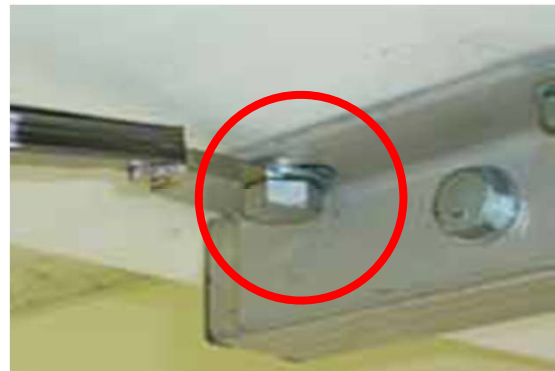
【三陸局】 ストラクチャ固定ボルトに緩みあり
