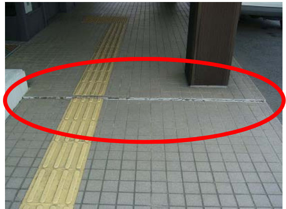
庁舎玄関 タイル沈み込み
