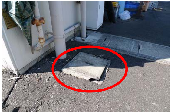
局舎周辺 雨水升破損
