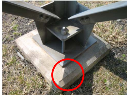
モルタル割れ
