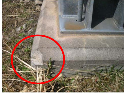
モルタル割れ
