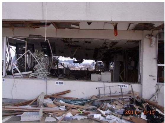
【気仙沼国道維持出張所】 ・事務室(1階建て)はすべて津波で流された。
