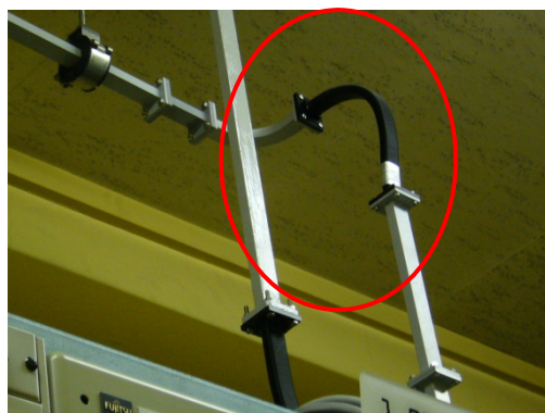
フレキシブル導波管に歪み有り
