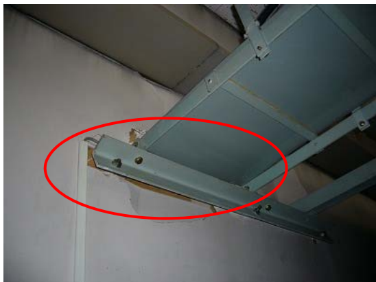
ケーブルラック壁面固定金具の壁面損壊
