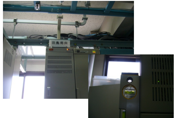
架に傾きがみられる
