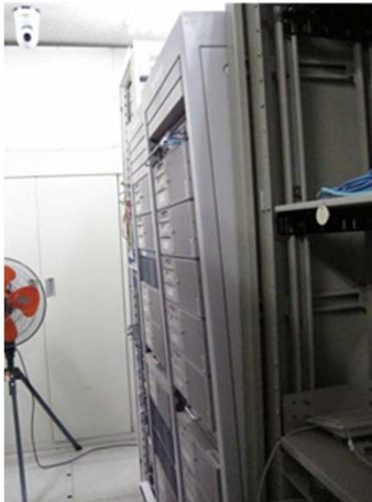
【東北地整 本局（仙台局）】 下部固定の列架：全体が傾斜している。
