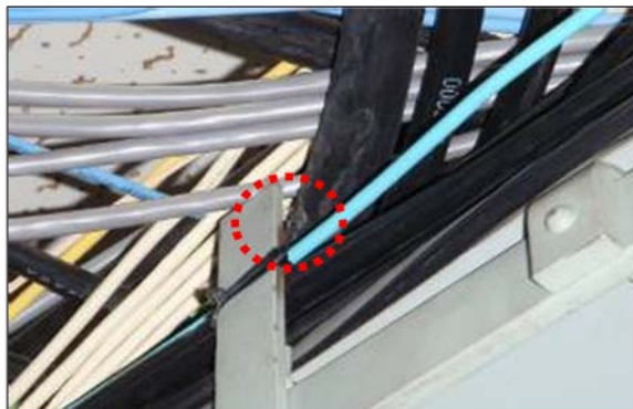
機器室 天井ラック拡大
