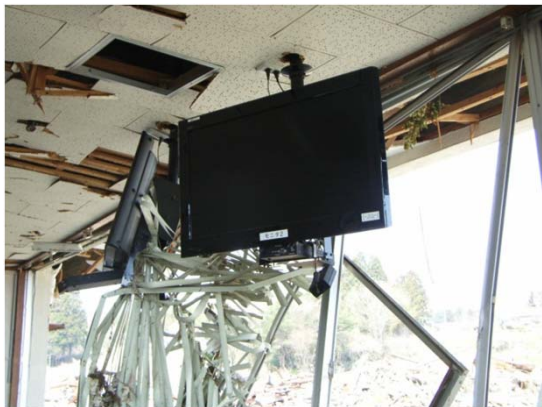
モニタ1、2(出張所1F) ・事務室(1階建て)は津波で流されており、装置も破損している。
