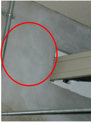
ケーブル導入口壁面亀裂あり
