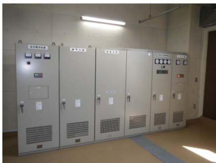
【鹿島台出張所】（無停電電源装置） 装置、外観に異常なし。 但し、蓄電池の電極部に結晶が発生しており、経年劣化と思われる。
