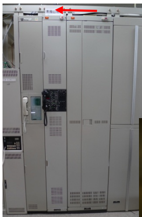
【一関河川局】 架が左に傾いている
