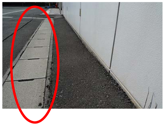
局舎周辺 U字溝沈み込み
