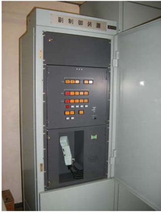
【釜台トンネル】 副制御装置据付ボルトのナットが一箇所外れていた。残り3箇所のナットも緩んでいた。
