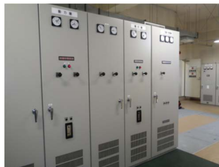
【鹿島台出張所】（直流電源装置） 外観、盤内機器類に異常なし
