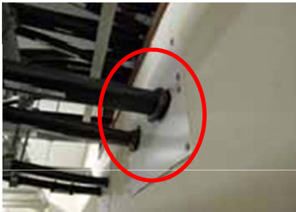
導波管が振動した形跡有り
