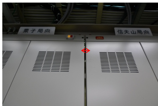
【福島局】 装置間隙間広がりあり
