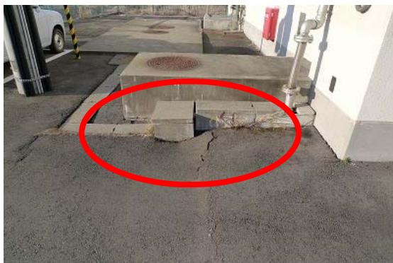
局舎周辺 舗装沈み込み
