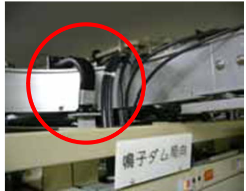
フレキシブル導波管に歪み有り
