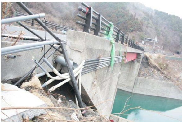
【R45 鳥谷坂橋付近】 情報管路被害 (三陸国道(事))
