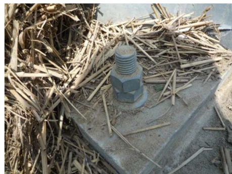
【気仙沼地区 情報板】 基礎ボルトに緩み(手で回る)
