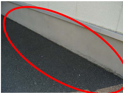
庁舎周辺 路面沈み込み
