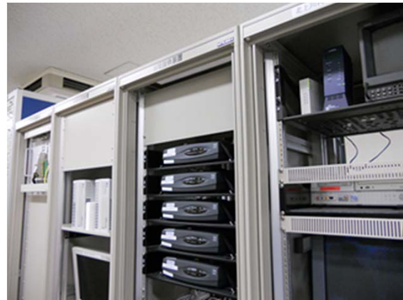
【一関河川局】 遠方監視制御装置、情報処理・提供装置等、下部固定のみであるが異常なし
