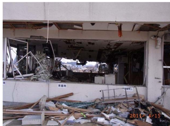
隣接する気仙沼国道維持出張所構内 (津波の爪痕)
