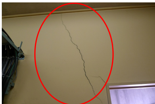
無線室内の壁面に亀裂有り
