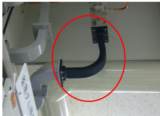
フレキシブル導波管に歪みあり
