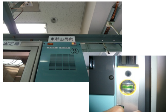
架に傾きがみられる
