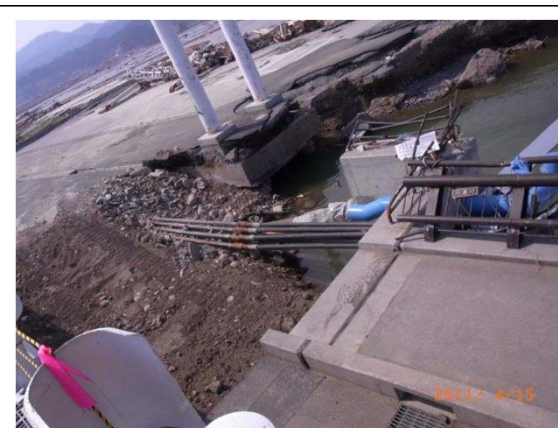
【R45 陸前高田市内】道の駅付近 山側(通信事業者)の管路被害
