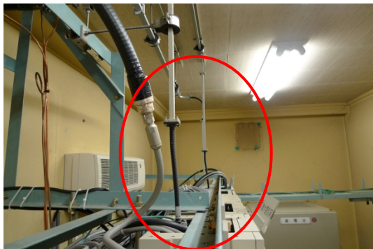
フレキシブル導波管に歪みあり
