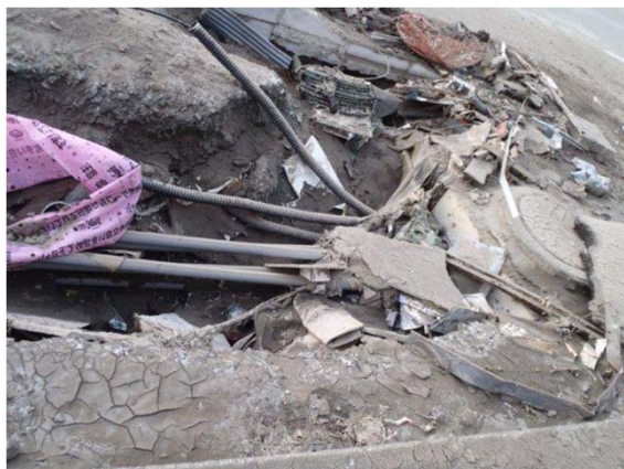
【R45 築地付近】 情報管路被害 (三陸国道(事))
