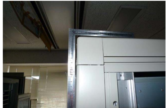
【郡山局】 架全体が捻じれている。
