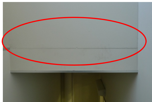
庁舎階段上部の壁に亀裂あり
