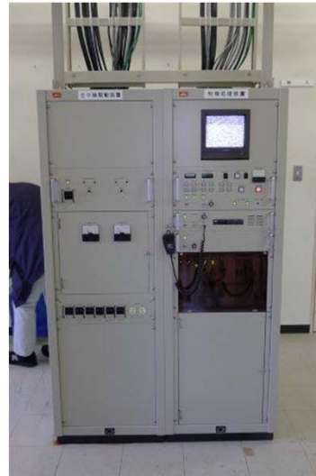
【青葉山局】 ヘリテレ受信装置：上下固定により異常なし
