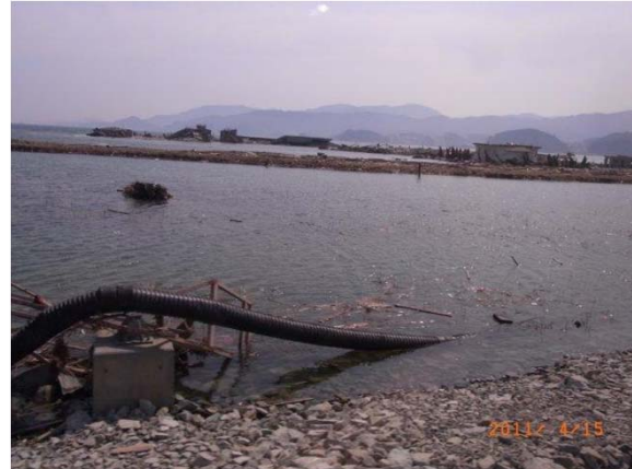
【R45 陸前高田市内】 情報管路被害
