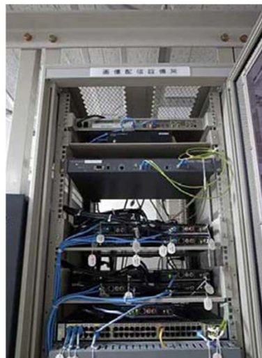
マルチキャストファイ ウォール等、IP機器 においても設置 状況に異常なし
