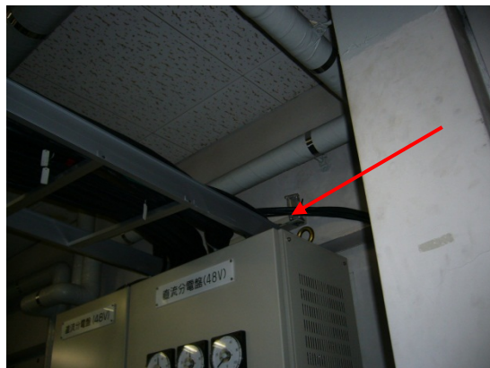
ケーブルラック取付具外れ
