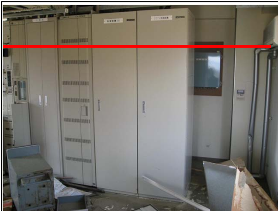
【気仙沼国道維持出張所】 ・中継所の2階まで水没しており、CCTV制御装置も水没している。 ・赤のラインまで水没している跡あり。
