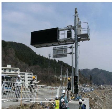
【片岸(下り)情報板/カメラ端末】 情報盤基礎が津波で露出している。
