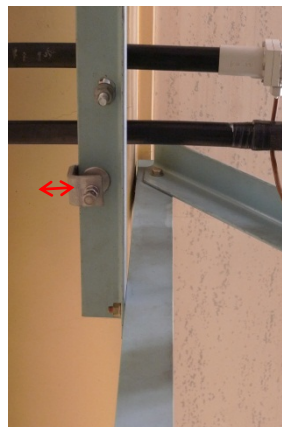
ケーブルラック壁面固定部に浮きあり
