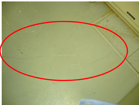
無線室内床面に亀裂あり
