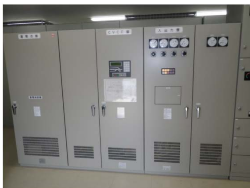
【新仙人トンネル第2電気室】（無停電電源装置） 装置外観に異常なし
