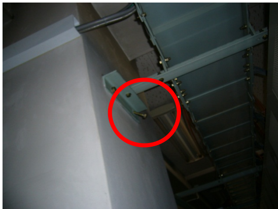
【仙台局】 壁面のストラクチャー受けのボルトの抜け有り。
