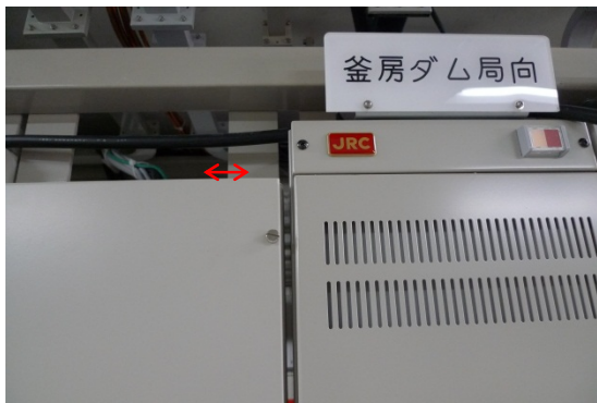
【石塚(仙台河川)局】 立架に傾きあり
