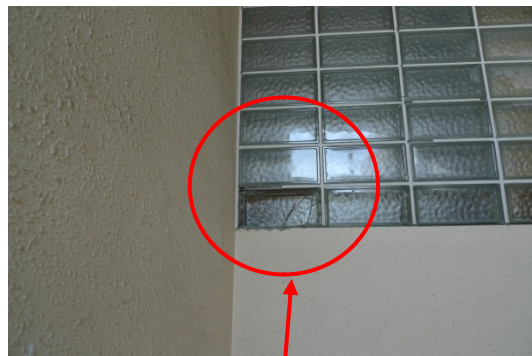
庁舎ガラスブロック損傷有り
