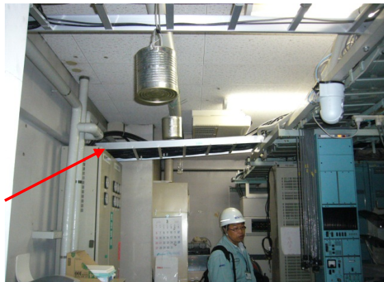
ケーブルラック取付具外れた為段差が生じた。
