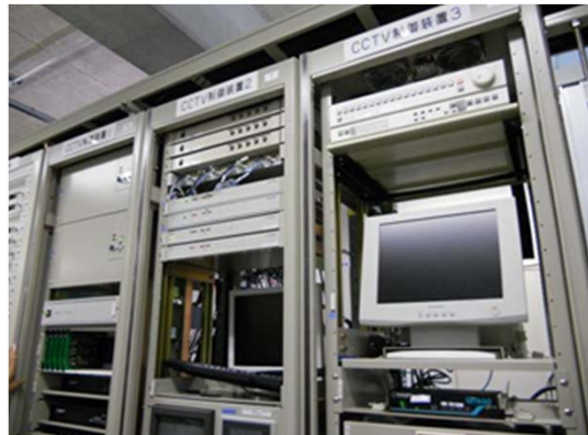
【福島局】 自立型CCTV制御装置収容ラック：上下固定により異常なし
