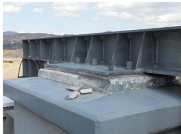
【一関河川局】 Xバンドレーダ雨量計用アンテナ基礎部の損傷
