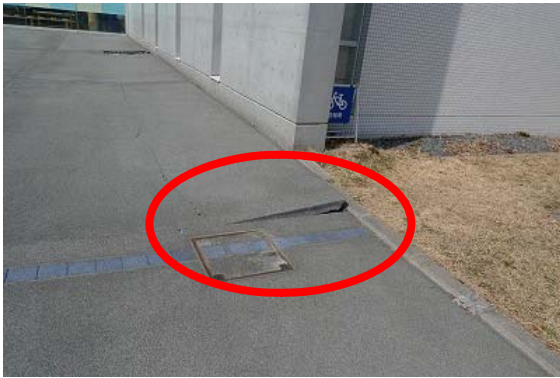
庁舎周辺 舗装浮き上がり
