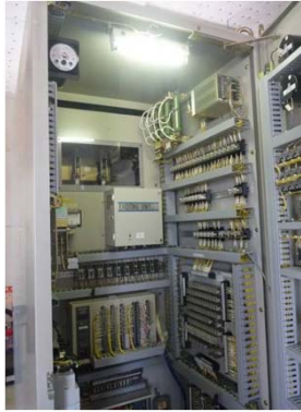
【北上川下流河川事務所】 外観、盤内機器、補機類等に異常なし
