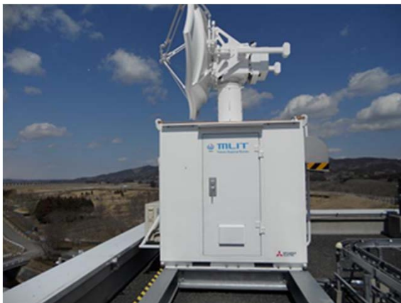
【一関河川局】 Xバンドレーダ雨量計観測装置、シェルター据付において異常なし
