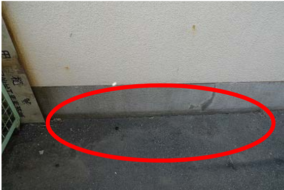
局舎周辺 路面沈み込み
