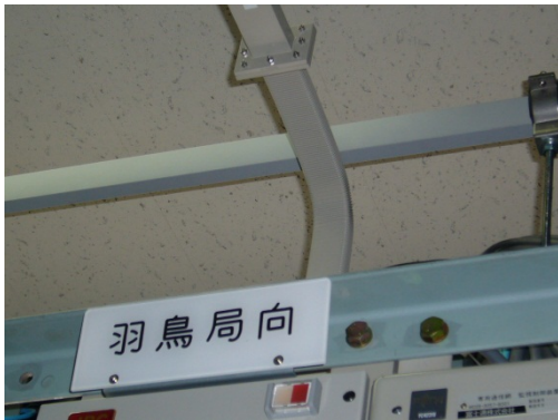
フレキシブル導波管に歪みあり
