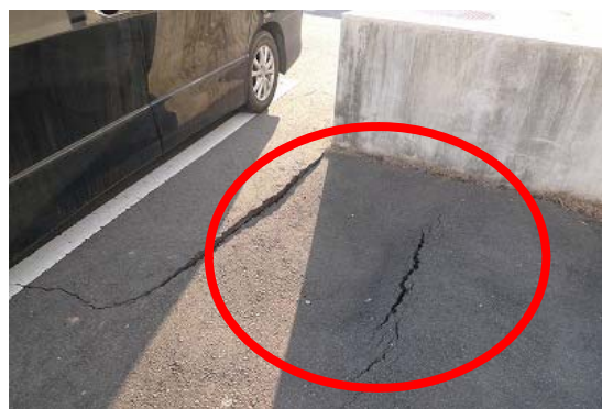
局舎周辺 舗装沈み込み
