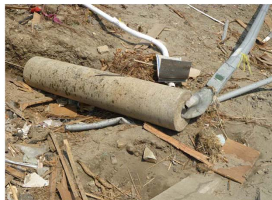
【大浜渡橋付近 照明柱】 津波により照明基礎が流出
