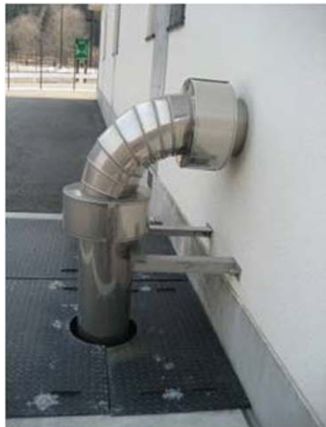
【仙人トンネル第2電気室】 排水管に歪みが発生
