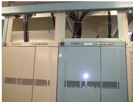
架上部取付・ケーブル引込状況に異常なし
