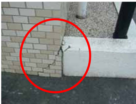
三陸国道事務所玄関前の亀裂の状況
