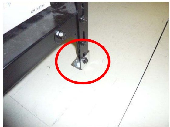
【釜石維持出張所】 汎用IT機器を搭載するラックがフリーアクセスのみにボルト接続されている。
