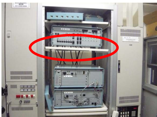
【箕岳無線中継所】 通信網監視制御装置、ルータ架(通信網監視制御装置の 上の棚が傾いている)
