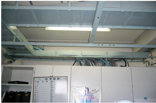
ケーブルラックに歪みあり
