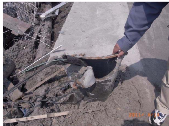
【破断した情報板支柱】
