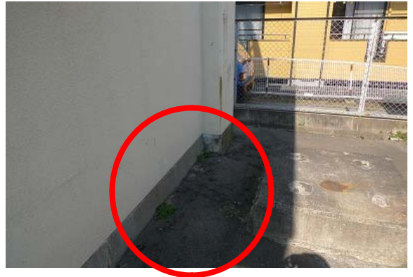
局舎周辺 路面沈み込み
