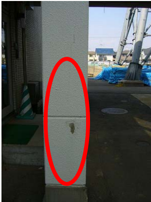
庁舎柱 亀裂・塗装剥離
