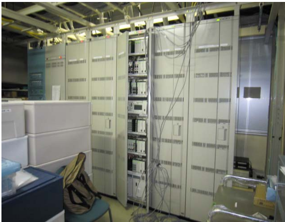
【福島河川国道事務所】 装置架の状況に異常なし
