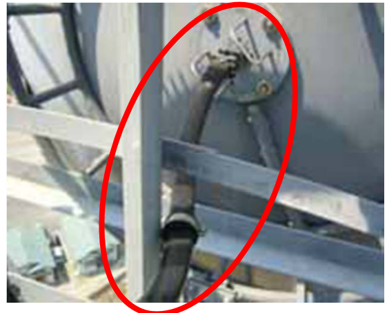
籠岳向け空中線架台が左に動き、導波管にストレスがかかっている。
