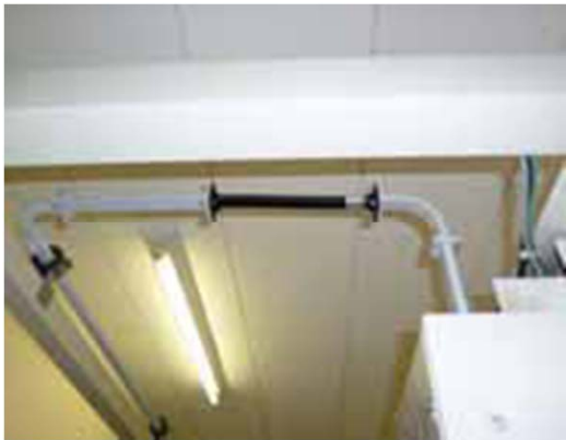
【鎌台南局】 フレキシブル導波管に歪みあり
