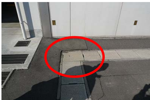
局舎周辺 舗装浮き上がり
