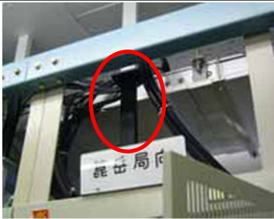
【北上川下流局】 フレキシブル導波管に歪み有り
