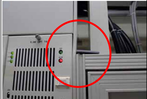
【釜石国道局】 架の揺れにより、筐体のつぶれが有り
