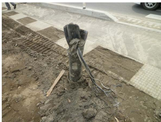
【(宮古市内 車両重量計測計設置場所) 照明灯】 津波により、開口部より破断
