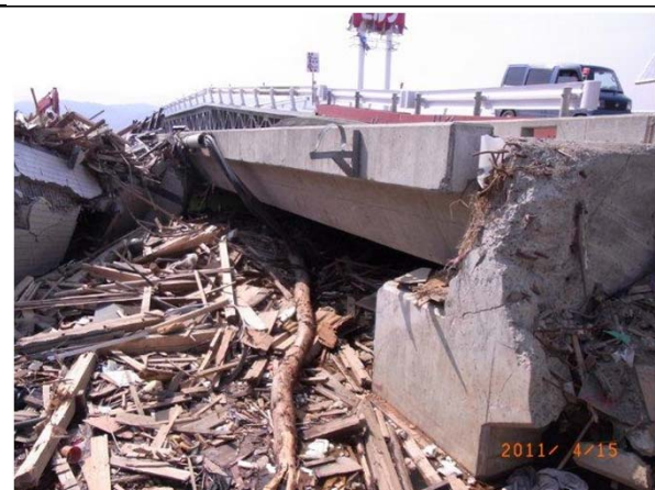
【R45 陸前高田市内】道の駅付近 海側の情報管路被害
