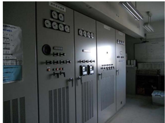
【仙台河川国道事務所】 受変電設備、発電機盤、電源盤等に異常なし
