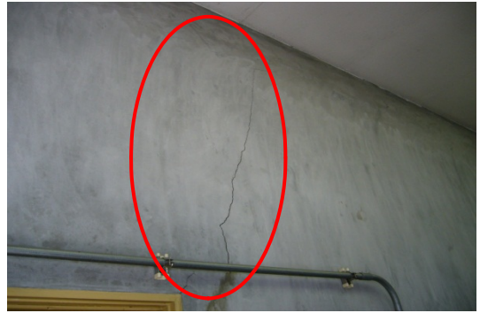
無線室内の壁面に亀裂あり
