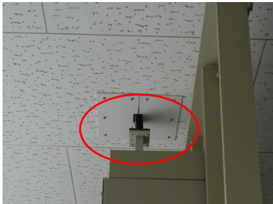
【古川国道局】 フレキシブル導波管に歪み有り
