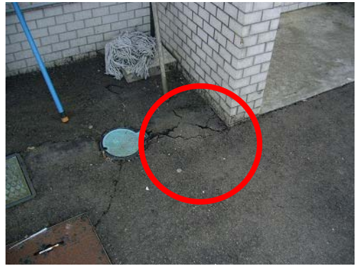
庁舎周辺 路面損傷
