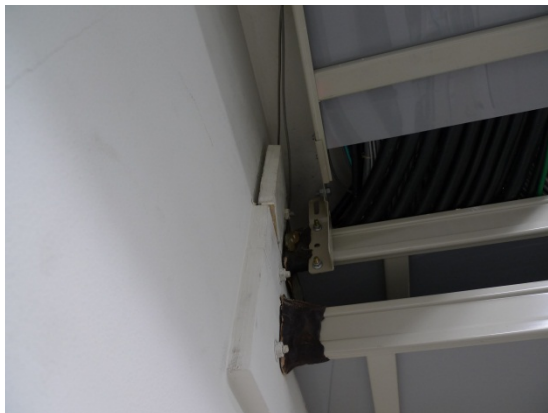
ケーブル引込口損傷
