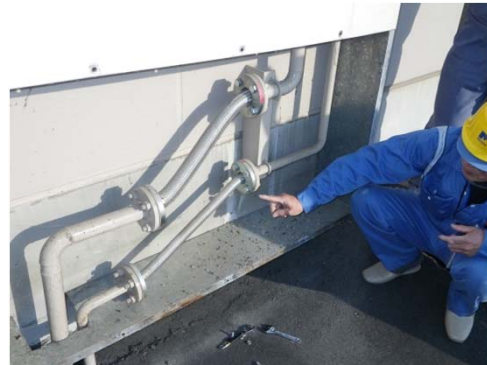
【鳴瀬川中流堰】 地下燃料タンクからの配管のフレキ部分が敷地内 地盤沈下(10cm)にて下部へ引張られ、緊張状態 となっている。
