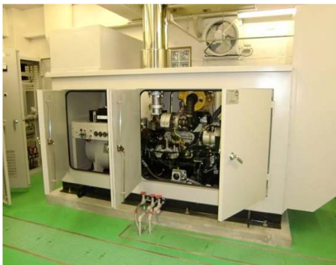
【北上川下流河川事務所】 外観、盤内機器、補機類等に異常なし
