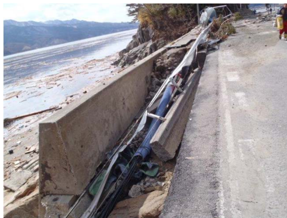
【R45 藤の川付近】 情報管路被害 (三陸国道(事))
