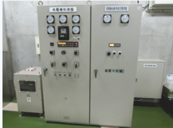
発電機制御盤、発電機始動用直流電源盤 装置の損傷は見られなかった。
