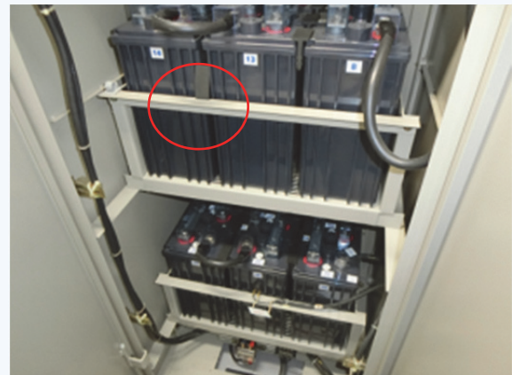
蓄電池 蓄電池セル間のスペーサが2箇所ずれていた。
