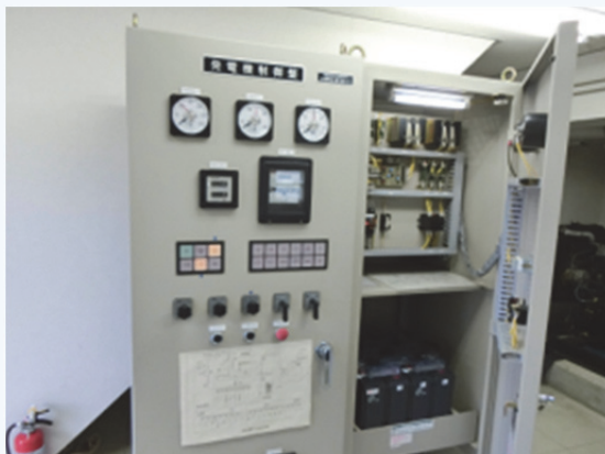
発電機制御盤、始動用直流電源装置 装置の損傷は見られなかった。
