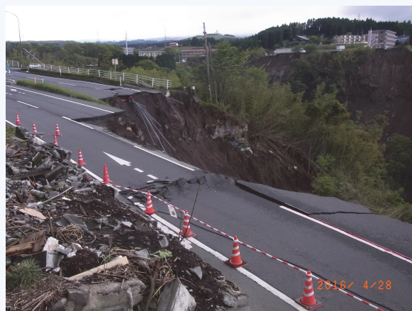
光ファイバケーブル切断箇所 (阿蘇側)
