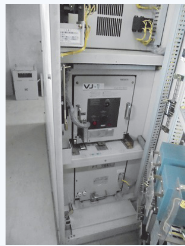
配電盤内部部品の欠落、破損など無し
