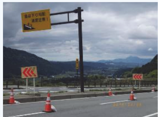
立野情報板周囲の状況 情報板の反対車線の標識柱に傾きあり （谷側に傾斜）
