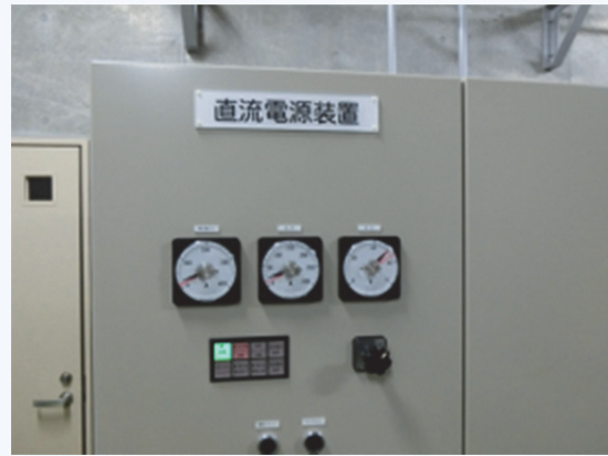
直流電源装置 (メータ部) 装置の損傷は見られなかった。
