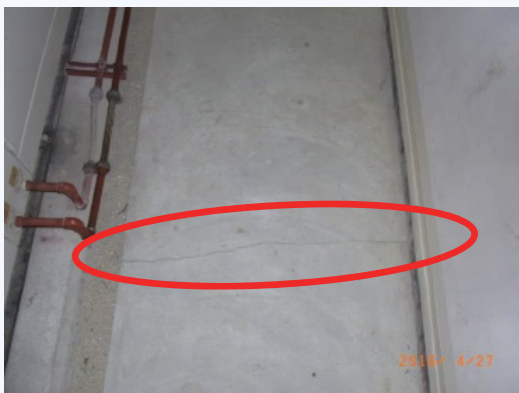
電気室 発電機横のピットに微細なひびが確認できる。
