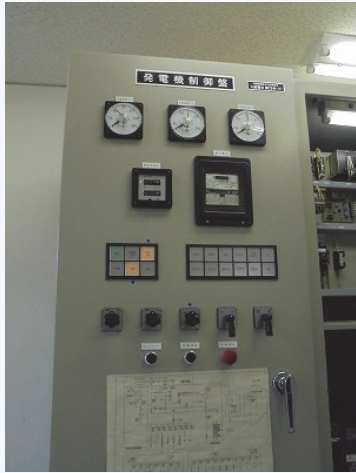
発電機制御盤の扉面表示に異常無し
