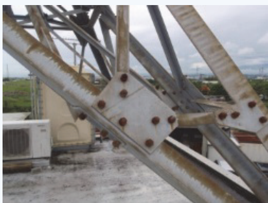
ボルトに錆が見られる
