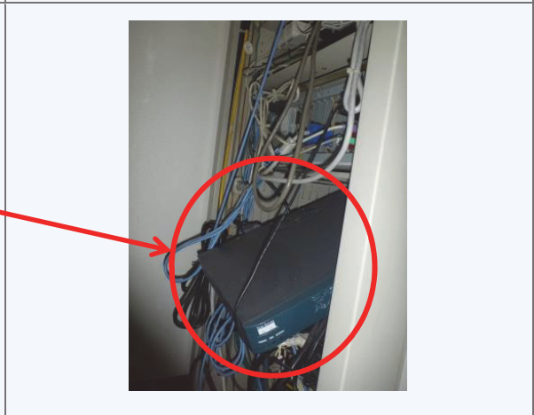
CCTV監視制御装置 内部機器のみ収納架から落下しかけている
