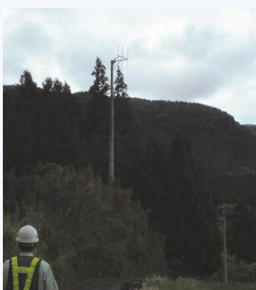
空中線及びパンザーマスト 外観上から傾きや異常は見られない
