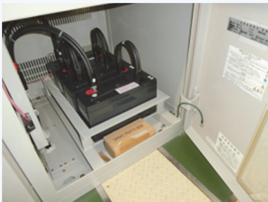
発電機始動用蓄電池 蓄電池の破損、変形は見られなかった。
