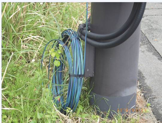
NHL 2形表示機 情報板の受電回路の二次側に発動発電機で臨時入力したと見られる電線が巻かれていた
