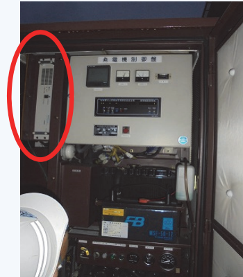
ディーゼル発電装置 盤内収納ミニUPS (正面左上) のブザー鳴動あり
