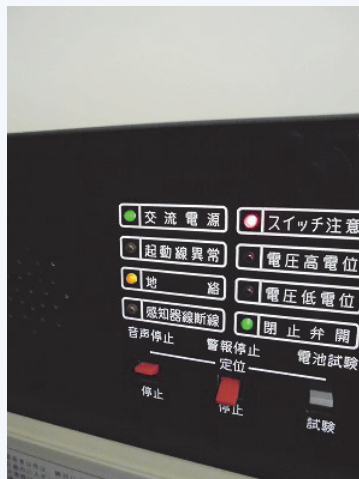
火災報知器盤に地絡ランプの点灯有り
