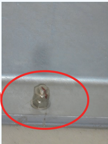
発電設備 据付ボルトに緩み無し
