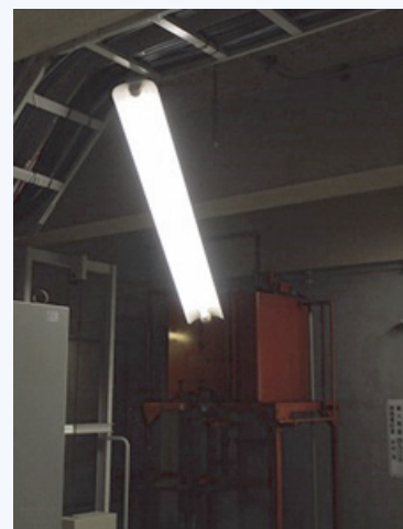
室内灯取付金具の片方が地震の振動にて破損
