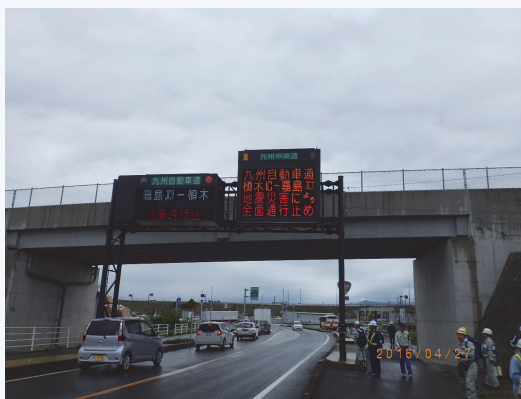
NHL 2形表示機 (特殊タイプ) (右側) 全景 (上り) (NEXCO西日本 BL 2型情報板 (左側) と共架) 目視では、門型柱の傾斜等は見られなかった
