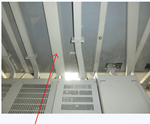
通信機械室 フレキシブル導波管の歪み有り。
