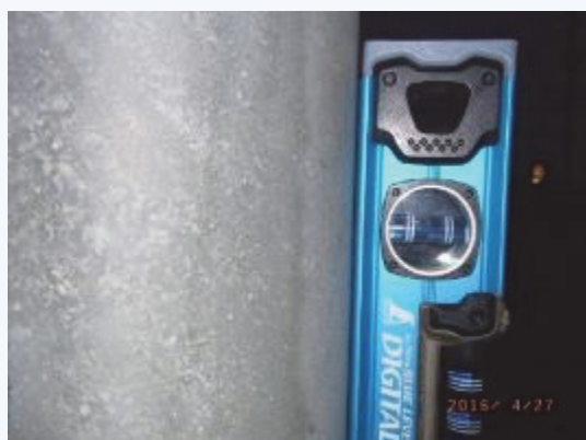
門型柱 (A 2 形正面視左側) 支柱がわずかに三角方向に倒れている模様 ただし、今回の地震の影響か否かは不明
