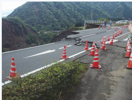
道路崩落箇所 (阿蘇側より熊本方面撮影)
