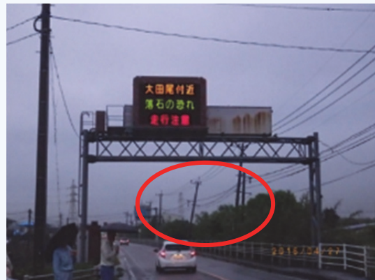
HL 2 形表示機 全景 運用中 (情報板周辺の電柱に傾斜が見られた)
