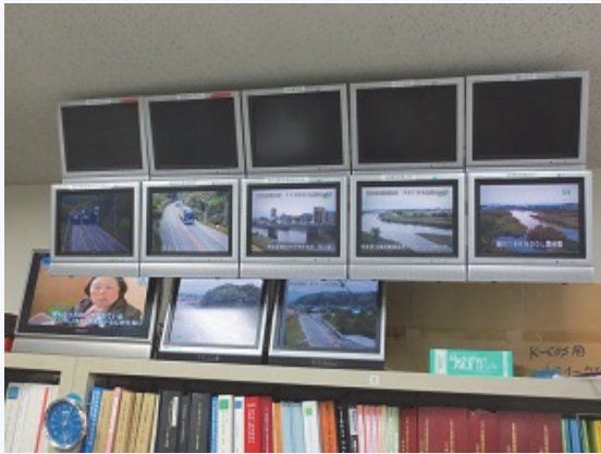
監視モニタ 壁面取付異常なし。 伝送路上の影響で一部カメラ映像が停止している
