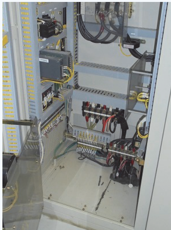
発電機制御盤の盤内に異常無し
