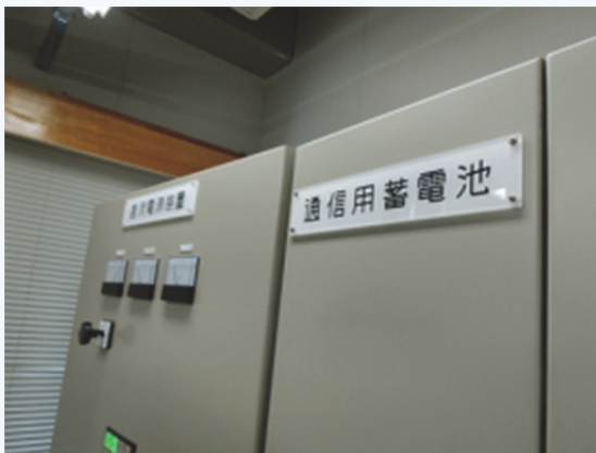
直流電源装置、通信用蓄電池盤 装置の損傷は見られなかった。
