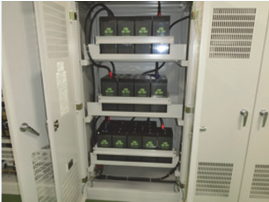
蓄電池盤 蓄電池の破損、変形は見られなかった。
