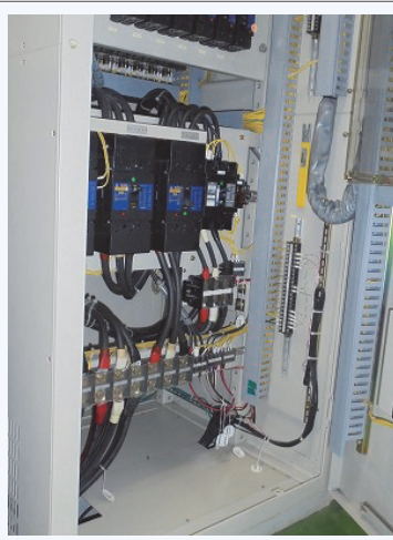
発電機制御盤 盤内部に部品の欠落、破損など無し
