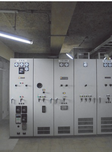
配電盤扉面表示に異常表示無し
