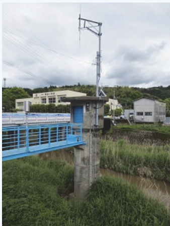
テレメータ雨量観測所 全景
