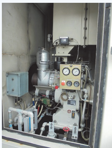
発電設備 装置内部に異常無し
