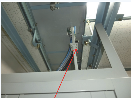
フレキシブル導波管の歪み有り。
