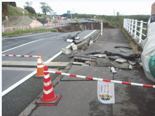
道路崩落箇所 (熊本側より阿蘇方面撮影)
