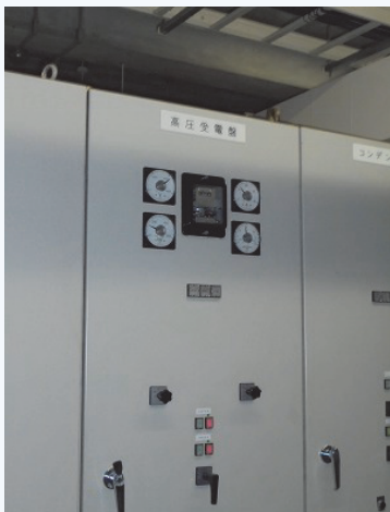
高圧受電盤 扉面表示に異常無し
