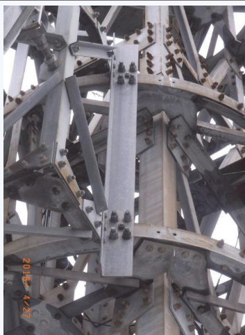
パラボラアンテナ架台の振れ止め 上下4本のUボルトによる従来の架台固定に加え、新たに各1本の固定ボルトを追加する耐震固定が施されている。
