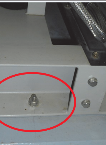
発電装置の据付ボルトに緩み無し
