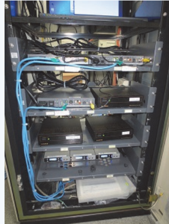
CCTV監視制御装置 内部状況 一部、内部実装機器の位置のずれが発生している
