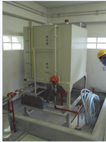
燃料小出槽に異常無し
