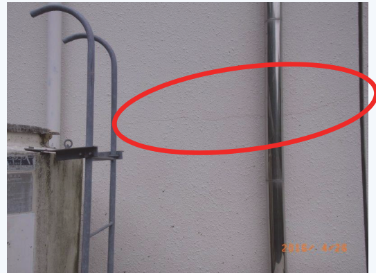
燃料タンク横壁に横方向の微細なひびが確認できる。
