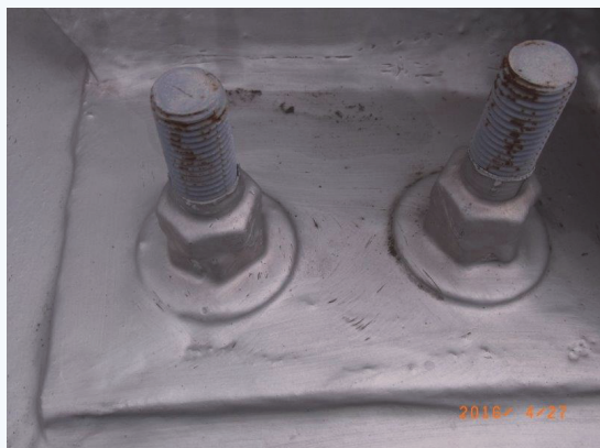
アンカーボルト、ベースプレートの塗装においても、 震動による塗装の切れは生じていない。
