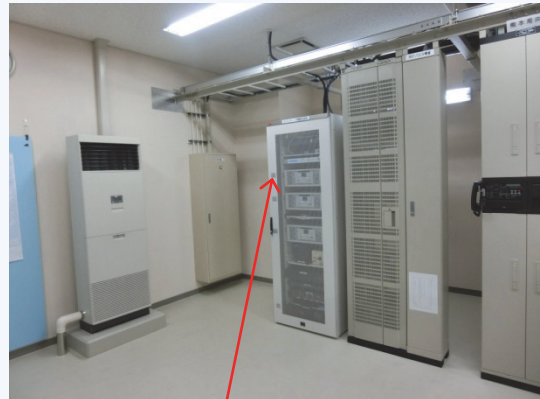
熊本地震（本震）の時刻に停電発生。 ほぼ同時に AZ サーボパック動作異常発生。
