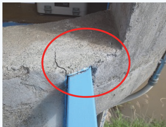
点検路取付部（右側手摺部分） 点検路と量水塔の取付部においてひび割れが確認 できる
