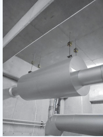
消音器インサート、吊り金具に変形など異常無し
