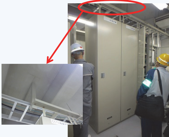
CCTV監視制御装置 架外観・ストラクチャ部の問題は見られない
