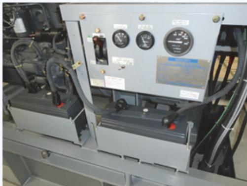
発電機用蓄電池 蓄電池の破損、変形は見られなかった。
