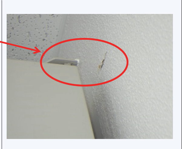
装置架が大きく揺れて壁面に衝突した形跡が見られる
