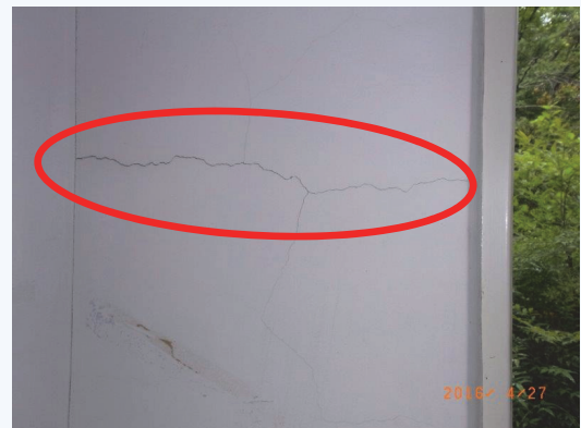
電気室入口部壁にひび割れが確認できる。
