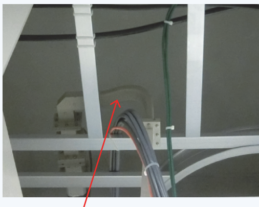
フレキシブル導波管の歪み有り。
