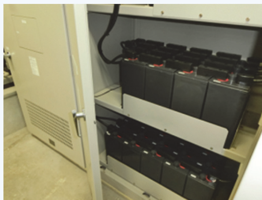
蓄電池 蓄電池の破損、変形は見られなかった。
