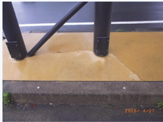
門型柱基部 (情報板正面視右側) (上り) アンカーボルト部がコンクリートで埋められており、基部の確認はできないが、埋設コンクリートにひび割れあり。ベースプレートの浮き、アンカーボルトの伸び等の有無確認と補修が必要
