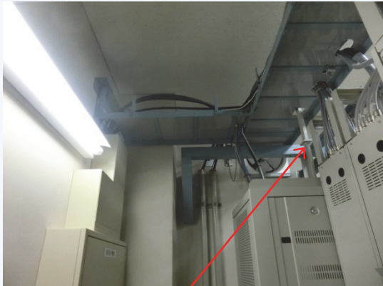
フレキシブル導波管の歪み有り。
