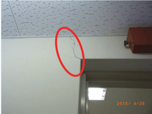
2 F 無線室 入口部に亀裂がみられる。
