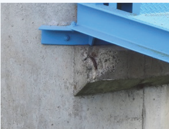
点検路取付部（左側土台部分） ひび割れ等の異常は見られない
