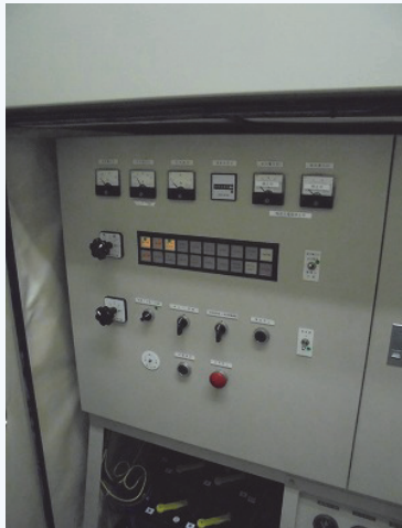
発電設備 装置内部の操作パネルに異常表示無し
