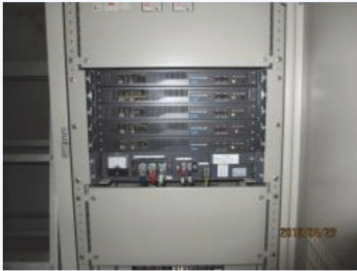
DC-AC インバータ盤のユニット No. 4 の故障ランプが点 灯していた。
