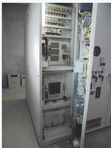
VCB、PT CELL接続位置に異常無し
