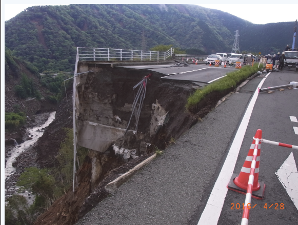
光ファイバケーブル切断箇所 (熊本側)
