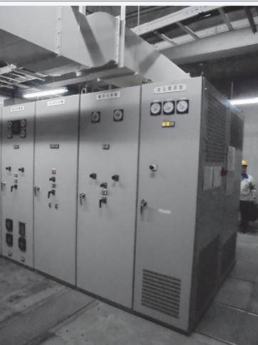
配電盤外観に異常無し
