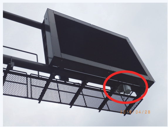
経路情報収集装置アンテナ（情報板に共架） 取付状態に脱落等の異常なし
