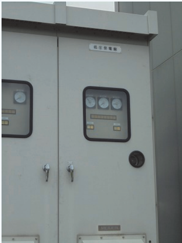
受電盤に異常表示無し受電盤に異常表示無し
