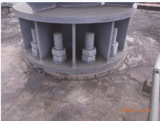
アンカーボルトの緩み、ずれ等の痕跡は見られない。
