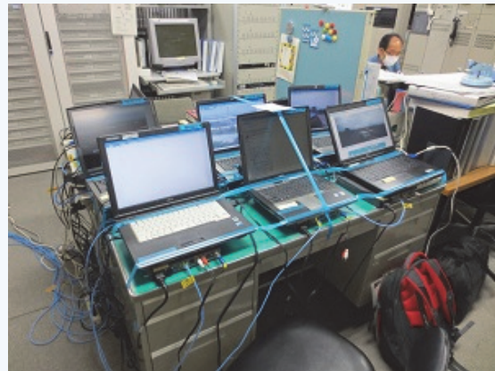
通信機械室 稼動しているカメラ用に仮設監視PCを設置している状況
