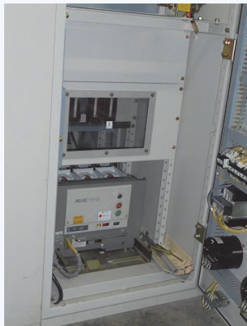
高圧受電盤 盤内機器に異常無し
