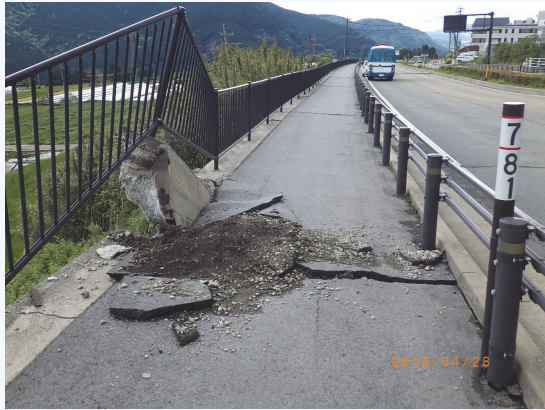
立野情報板周囲の状況 国道 57 号立野地区(阿蘇大橋西側)の崩落現場に近く、 道路の損傷が激しかった
