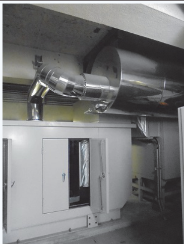
発電設備 装置に破損・変形、据付位置のずれ無し
