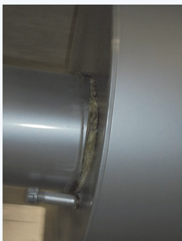
隙間から断熱材の一部が露出
