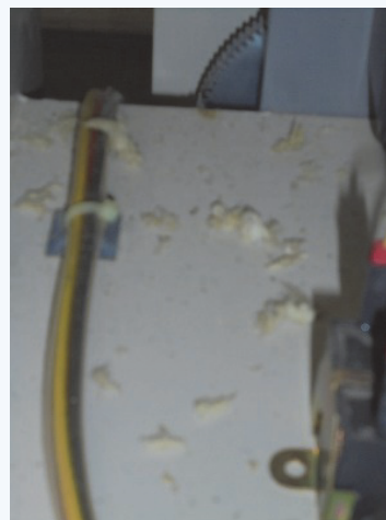
消音器の下に断熱材の破片が落下していた
