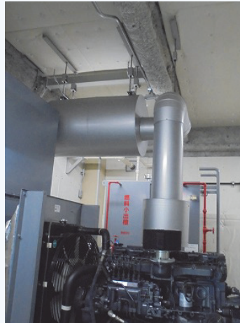
発電設備 消音器のインサート、吊り金物に歪み無し
