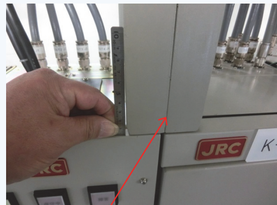
振れ止め金具のずれが見られる。
