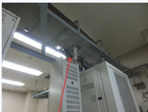
フレキシブル導波管の歪み有り。
