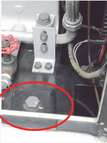
発電設備 据付ボルトに緩み無し
