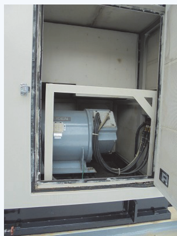
発電設備 装置内部に異常無し
