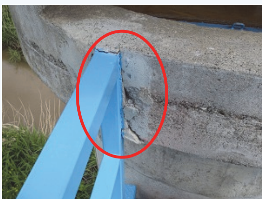
点検路取付部（左側手摺部分） 点検路と量水塔の取付部においてひび割れが確認で きる
