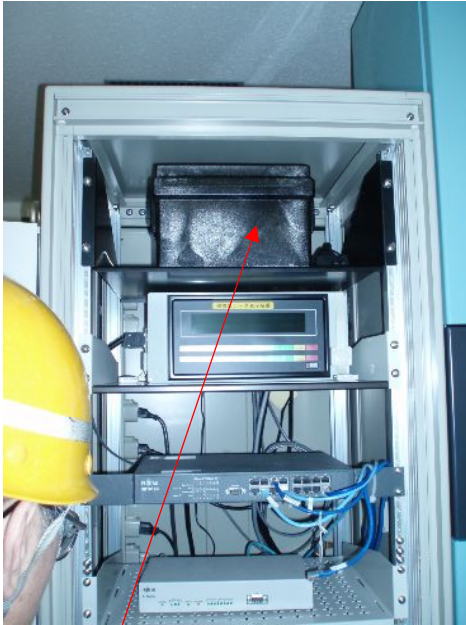
地震により筐体裏扉を突き抜けて後方に落下した地震計の記録装置。(石澗ダム)
