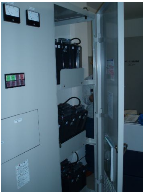
直流電源装置内のバッテリー（中段）が傾斜 (石澗ダム)
