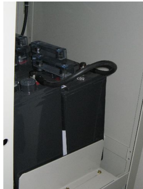
背面の傾斜状況
