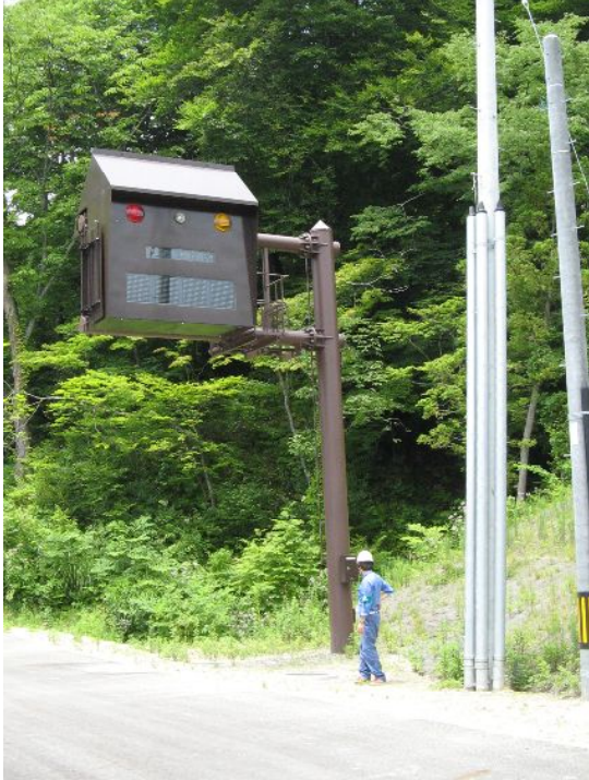
トンネル非常警報表示板が傾斜
