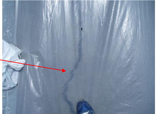
ダム天端の縦断方向の亀裂
