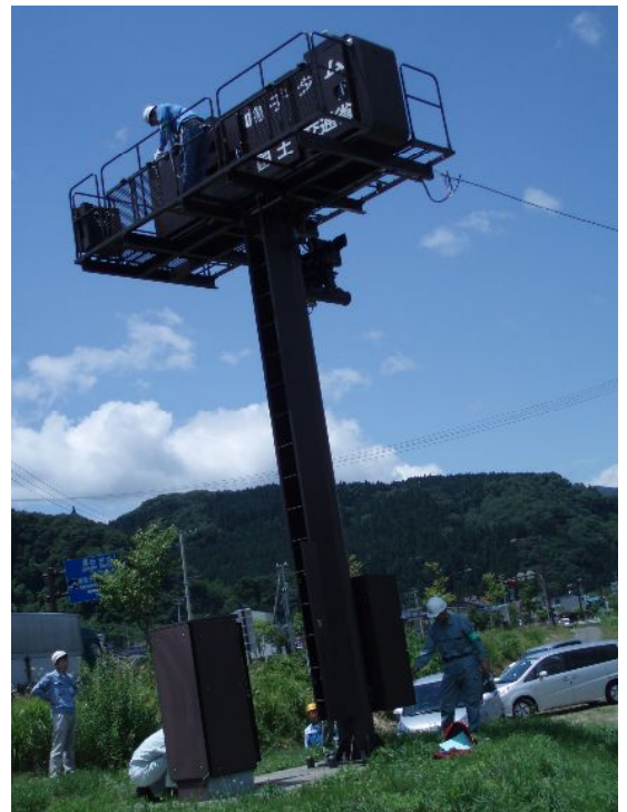
(3) 中野放流警報表示板調査 （鳴子ダム）
