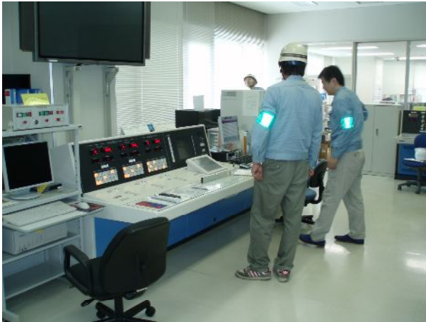
ダム放流設備制御装置調査（鳴子ダム）
