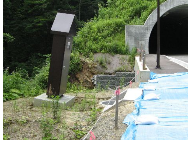
照明制御盤が傾斜
