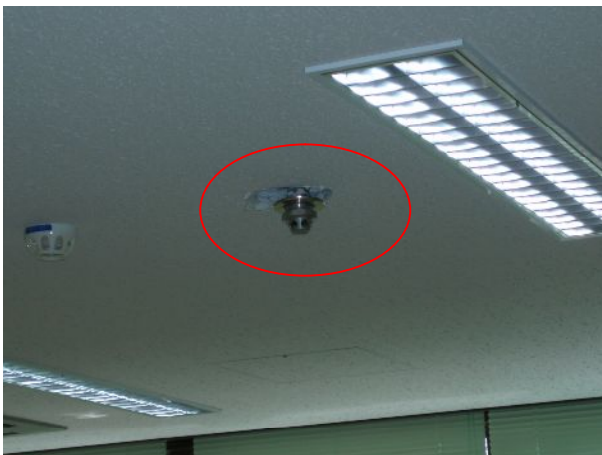
CO 2 消化設備噴射口部の天井壁が一部剥離 （石渕ダム）
