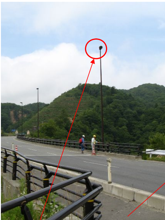
照明灯具をポールに固定するカ所がゆるみ 灯具の向きが変化
