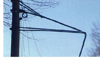
写真-6 R45(259.7KP) 宮古トラカン支柱アーム折損
