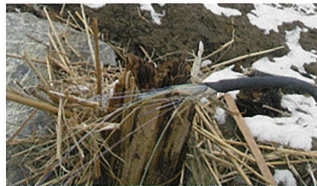
写真-11 光ケーブル切断(北上川河口)
