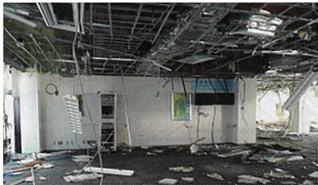
写真-7 R45(264.1KP) 道の駅みやこ情報提供装置設置フロア浸水
