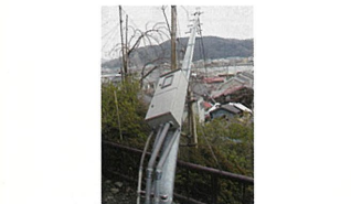
写真-16 日和山公園CCTV電源引込み柱倒壊(旧北上川河口)
