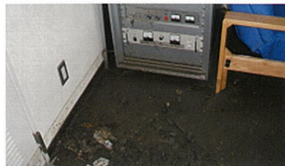
写真-17 野蒜水門水位テレメータ局舎内浸水(鳴瀬川)
