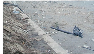
写真-9 R45(342.4KP) 米田海岸CCTV 支柱流出
