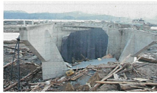
写真-2 R45(154.5KP) 沼田跨線橋 情報 BOX破損・光ケーブル切断
