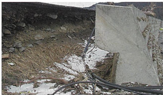
写真-10 光ケーブル流出・切断(北上川河口)
