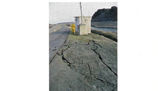
写真-18 鹿島台水位テレメータ支柱傾斜(鳴瀬川)
