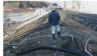
写真-12 月浜第一水門光ケーブル流出・切断(北上川河口)
