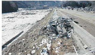
写真-8 R45(276.3KP) 大平橋 光ケーブル切断
