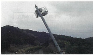
写真-1 R45(152.0KP) 気仙大橋CCTV 支柱傾斜
