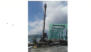
写真-15 B新北上大橋CCTV支柱傾斜、引込開閉器盤内浸水(北上川)
