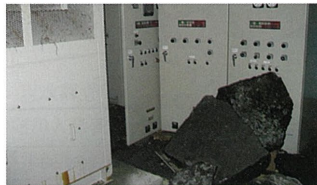
写真-14 月浜第一水門電気室浸水・岩石流入(北上川河口)
